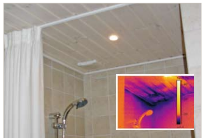
Fig. 240.9. Termografi af aftræk. Selve dækslet er koldt. Det kan forventes, men der kommer også luft ind under flangen og ved skyggelisten. Der er ikke tætnet tilstrækkeligt.
