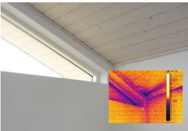
Fig. 240.8. Termografi af vindue. Selve vinduet kan forventes at være koldere end væggen, men der bør ikke være mørke striber fra skyggelisten og ind.
